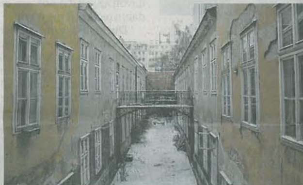
Das Gebäude war ursprünglich in einem schlechten Zustand
