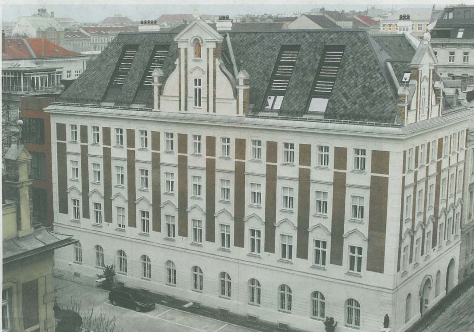
Aus alt mach neu: Das Klostergebäude in der Kaiserstraße 7 in Wien Neubau wurde umfangreich saniert und ging als Sieger des diesjährigen Bewerbs hervor
